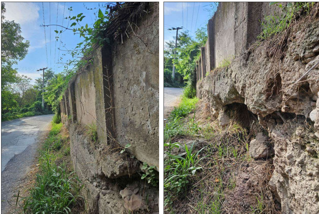
Slika 2 Potporni zid (ograda) – Dformacija u vidu rotacije ograde. Lokacija najugroženijeg dela ograde.
