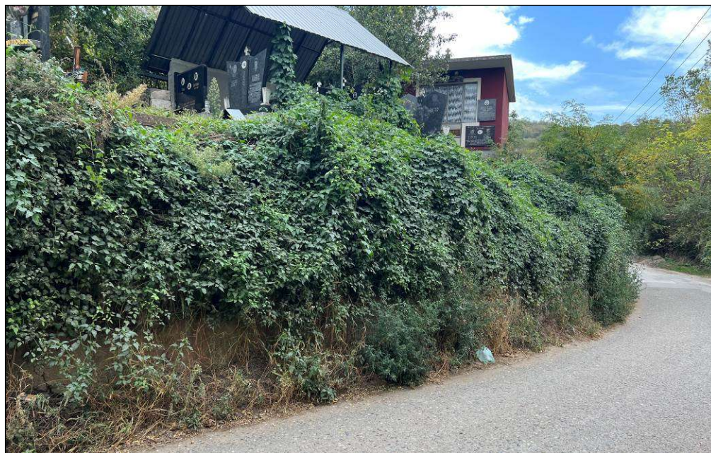
Slika 8 Potporni zid (ograda) – Guste vegetacija preko selog zida.
